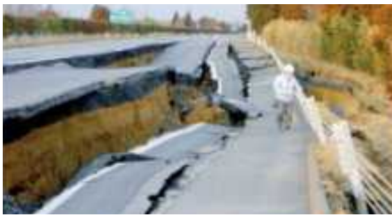
路面が陥没した常磐自動車道(水戸IC～那珂IC) 出典：東日本大震災の記録誌 茨城県
