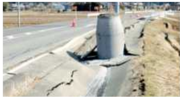
浮き上がったマンホール(常陸太田市) 出典：東日本大震災の記録誌 茨城県
