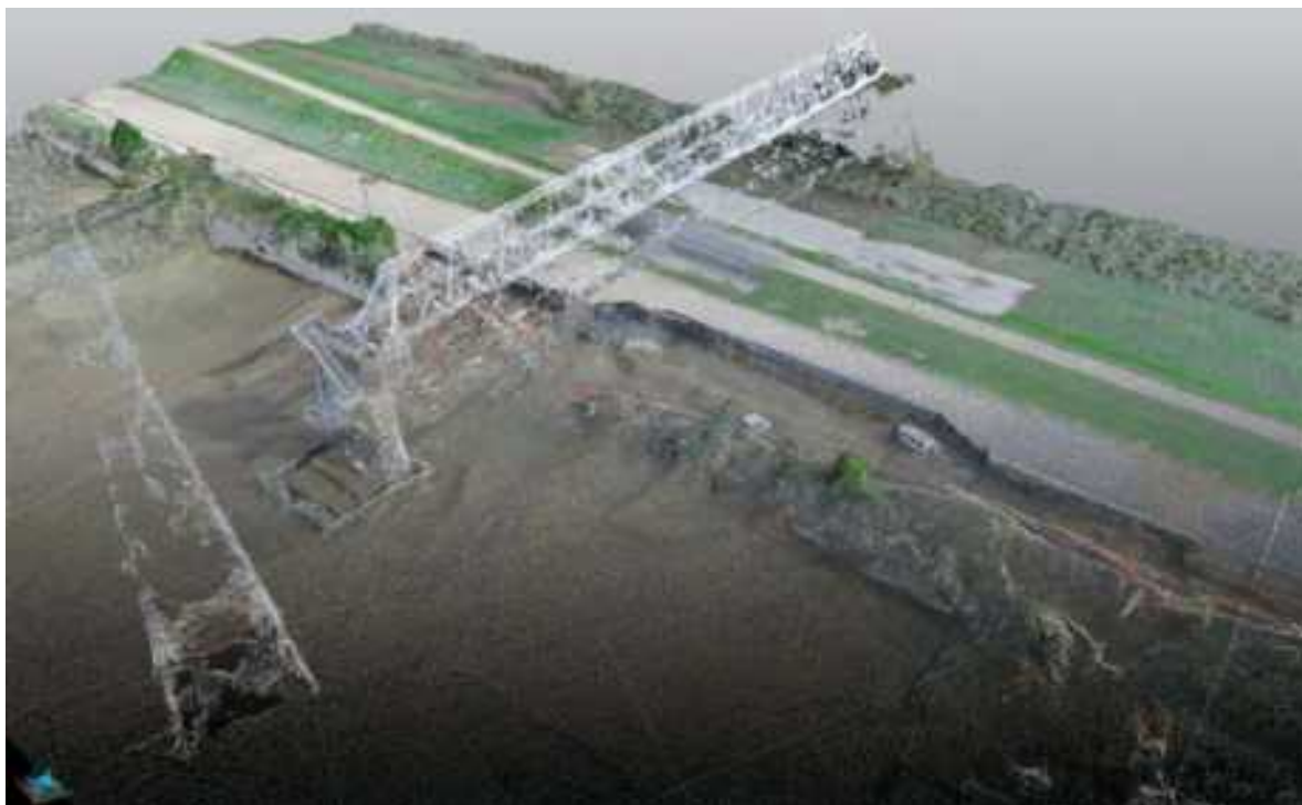
3次元データ活用 令和元年台風第19号被害(那珂川(水戸市)) (令和元年10月)
